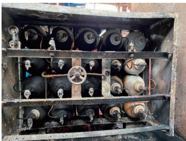
事故を起こしたカードル(前面)
