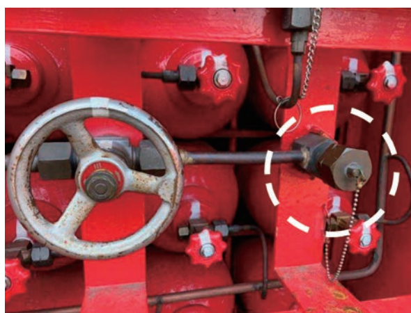
今回の事故発生カードルと同タイプ (○印内の銅管付け根部分が破断)
